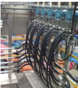
Chemikalien- und Farbstoffdosierung
